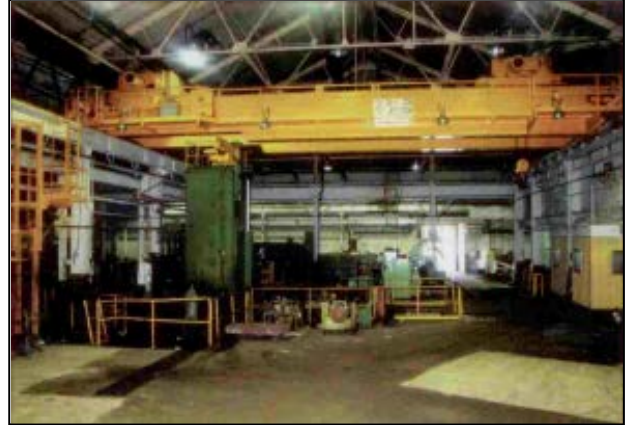
37/25 Ton – 65' Span P&H Crane
